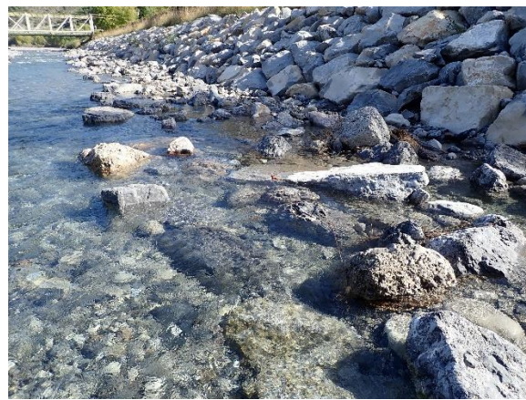
Photo 9 : Blocs effondrés dans le cours d'eau
