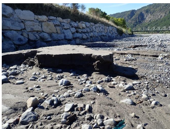
Photo 2 : Traces de dépôt épais de limon dans le lit majeur et traces d'érosion récente
